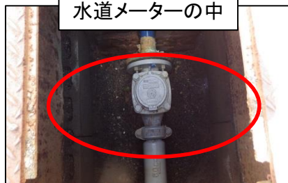
水道メーターの中
